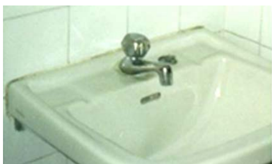
I bambini hanno rilevato lo stato di degrado dei sanitari presenti nella loro scuola
